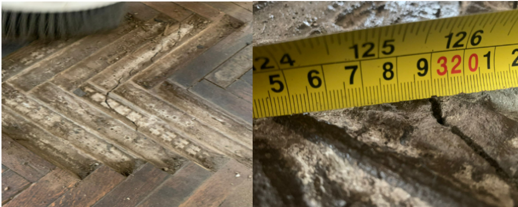
Figura 7. Ancho de grieta en la exploración
